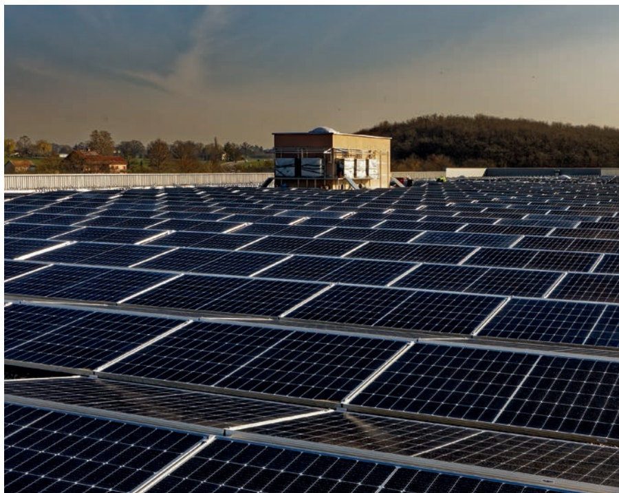
ZI du Bois-de-Bay : toiture solaire photovoltaïque
